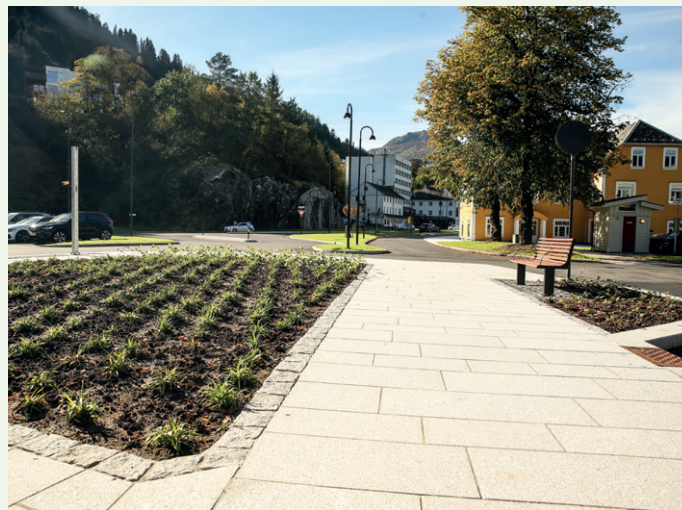
Det er plantet 2.500 planter i forbindelse med Tiltak 14 i Førdepakken. Som her ved krysset mellom Fjellvegen og Hafstadvegen.
